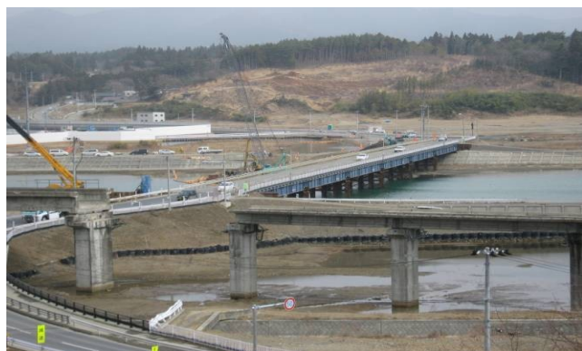
写真8 津波で欠落した橋梁
